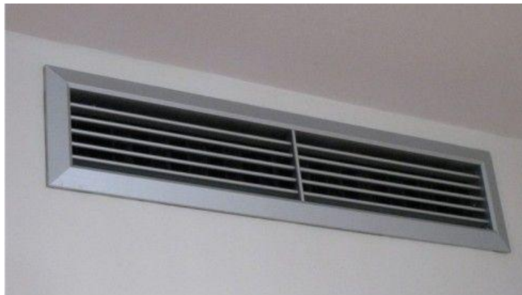
Figura 26. Ventana entrada de aire
