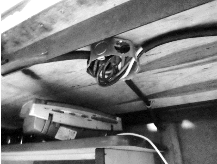
Figura 13. Instalaciones eléctricas bancos de trabajo
