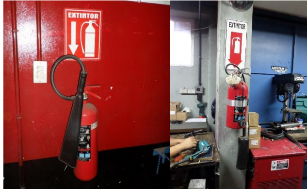
Figura 45. Señalización de equipo contra incendios en área de taller
