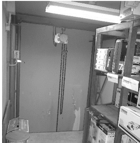
Figura 21. Ubicación controles del elevador de carga segundo nivel
