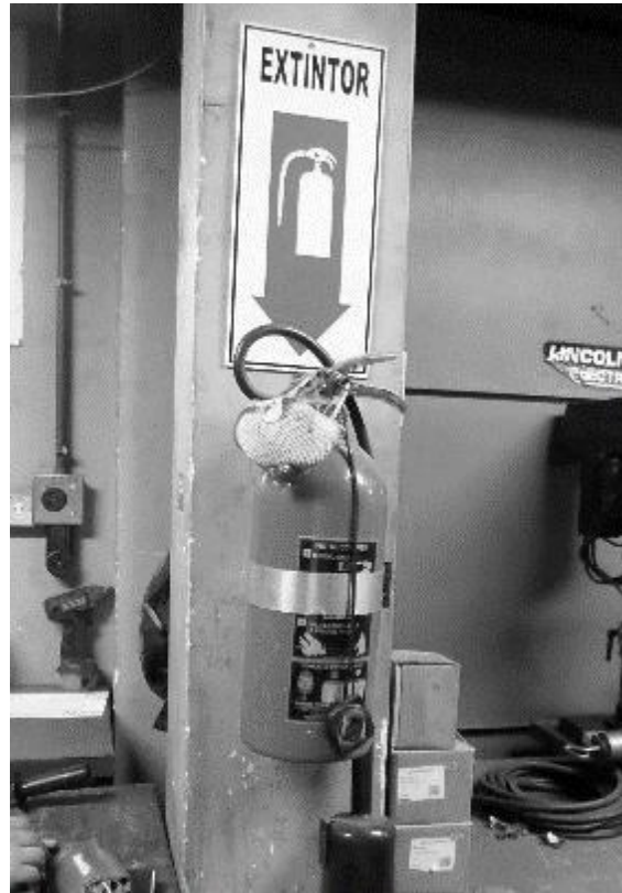
Figura 12. Extintores en área de taller
