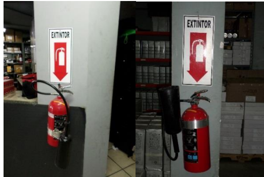
Figura 56. Señalización contra incendios bodega nivel 1
