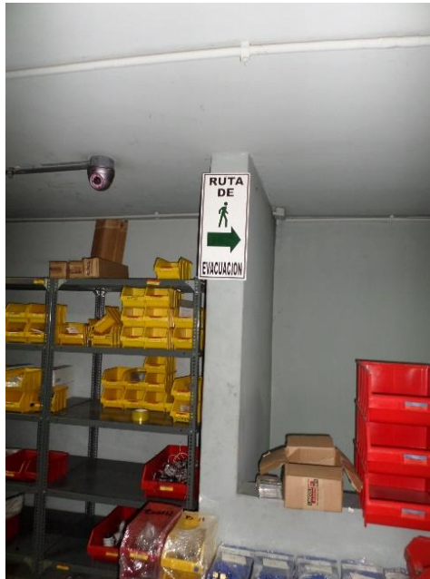
Figura 60. Señalización rutas de evacuación en área de bodega nivel 2
