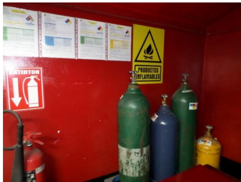
Figura 46. Señalización de gases industriales en área de taller
