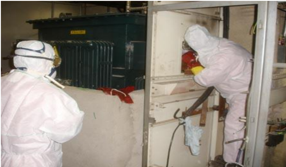
Figura 8. Manejo materiales de construcción peligrosos
