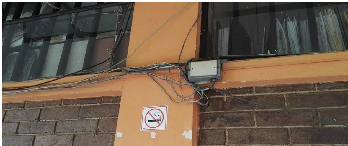
Figura 25. Sistema eléctrico en mal estado en la DDA
