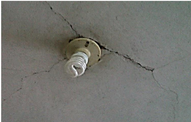
Figura 9. Fallas por flexión en la losa, debido a vibraciones, mala mezcla, mala fundición, poco recubrimiento en las instalaciones eléctricas embebidas y/o mal curado
