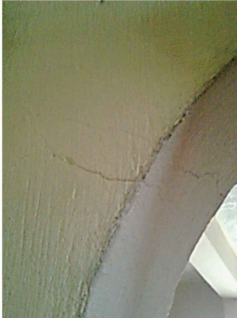
Figura 11. Falla por cortante en puerta, debido a movimientos sísmicos
