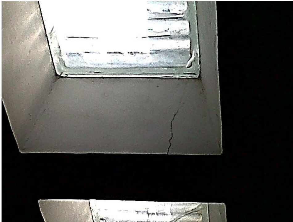
Figura 12. Falla por corte, debido a una mala colocación del tragaluz y la cercanía del otro, provocando debilidad en esa parte de la losa
