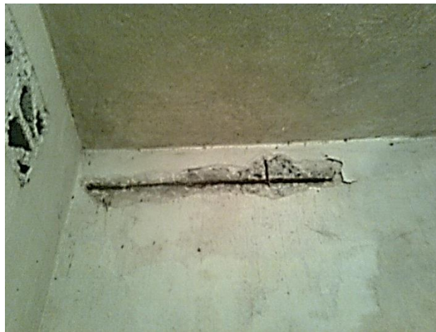
Figura 10. Falla de desprendimiento de recubrimiento, debido a poco recubrimiento y/o explosión del concreto por movimiento sísmico
