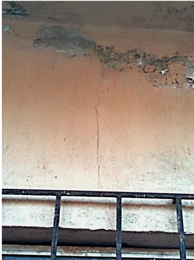
Figura 8. Falla por cortante en muro así como humedad en el mismo, esto debido a movimientos sísmicos y filtraciones en la losa y muro
