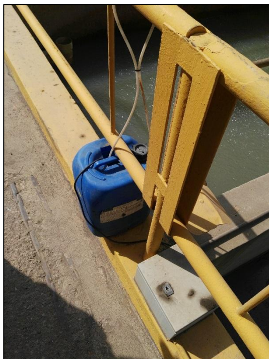
Figura 24. Sistema dosificador de líquido limpiador
