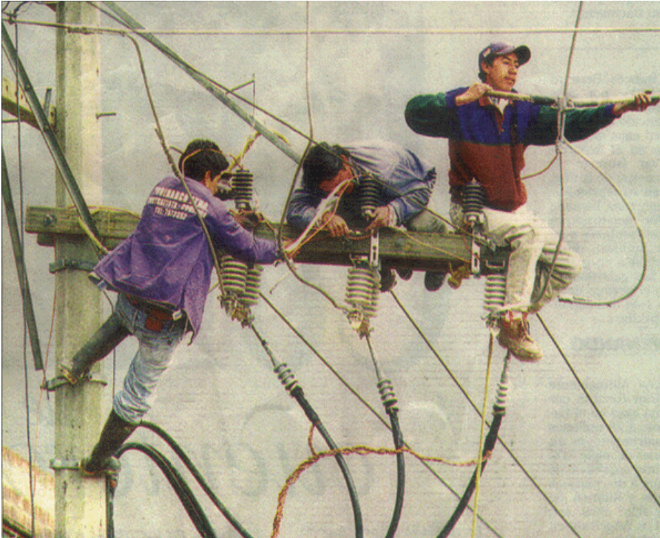
Figura 12. Riesgos de trabajo en alturas
