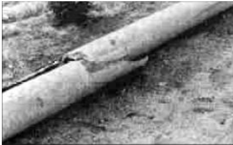
Figura 6. Compresión telescópica debido al movimiento de falla
