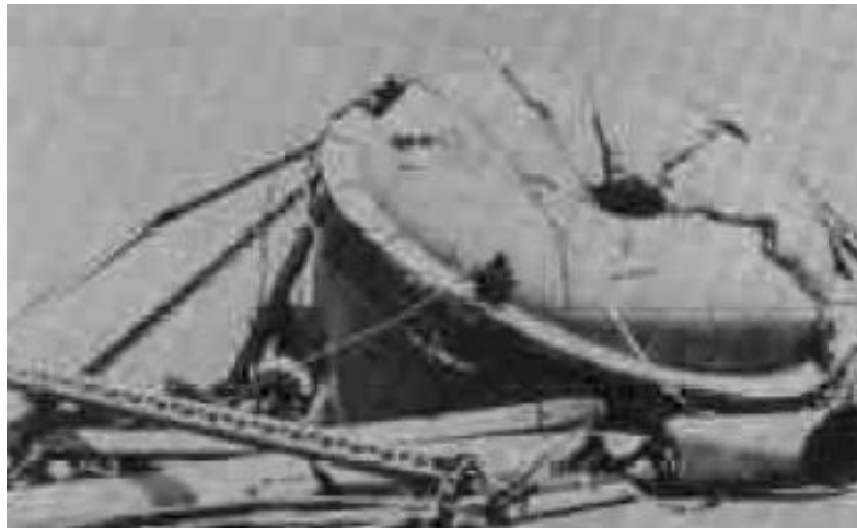
Figura 22. Colapso de un tanque elevado
