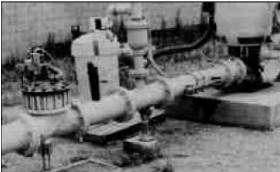
Figura 8. Fugas durante sismo debido a asentamiento en tubería de revestimiento
