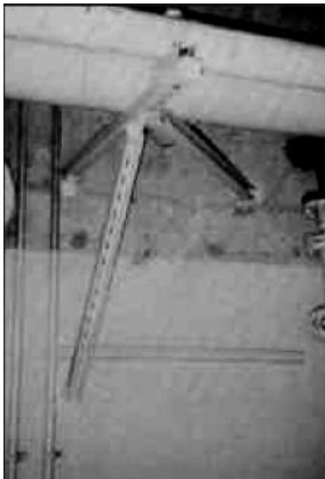
Figura 10. Tuberías apoyadas en tres direcciones ortogonales
