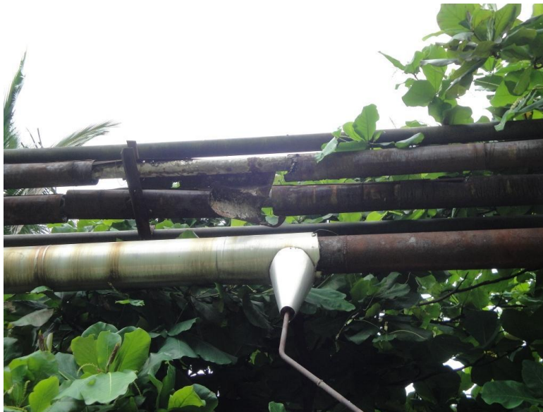
Figura 10. Tubería sin sistema correcto de evacuación de condensados
