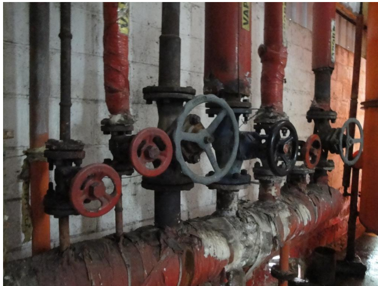
Figura 5. Manifold principal de vapor
