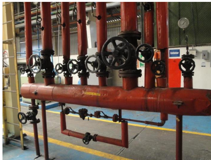
Figura 6. Sistema de trampeo mal diseñado en manifold de vapor
