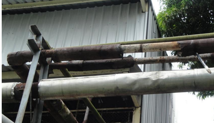
Figura 11. Ausencia de aislamiento en tubería de vapor
