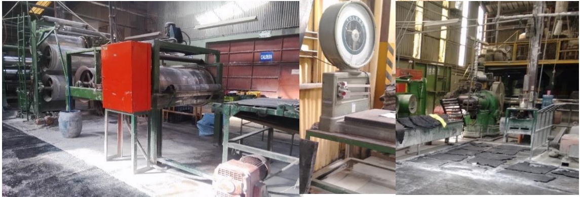
Figura 23. Instalaciones del área de calandra, planta 2
