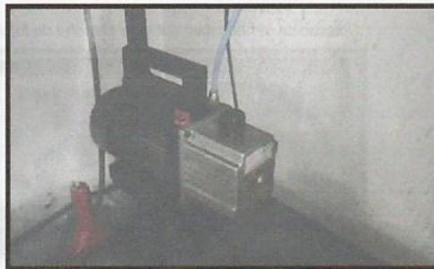
Bomba de vacío
