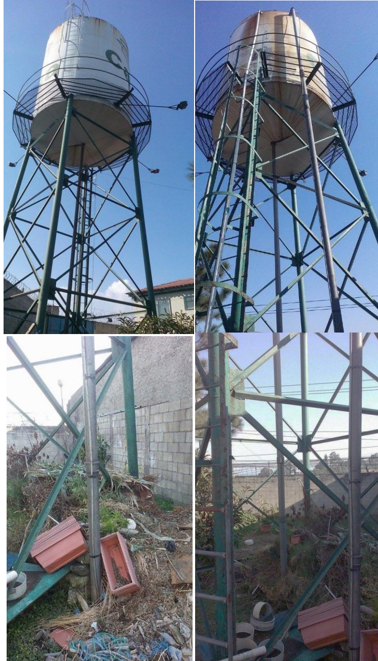
Figura 46. Imágenes de tanque de agua de la empresa
