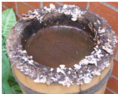
Figura 23. Pudrición no aceptable en bambú estructural
