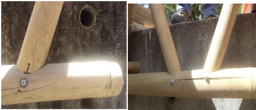
Figura 67. Falla por desgarre y tracción perpendicular en JB – B
