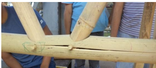
Figura 61. Falla por tracción perpendicular en JB – C1
