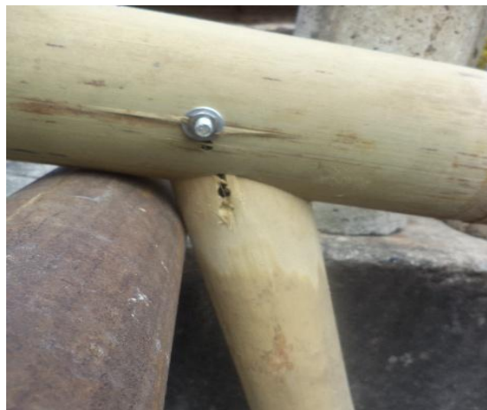
Figura 74. Falla por desgarre en JB – D3 sistema 3
