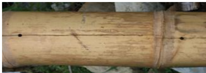
Figura 21. Grietas y picaduras no aceptables en bambú estructural
