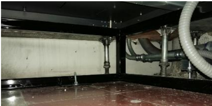
Figura 35. Base antisísmica para aire acondicionado de precisión
