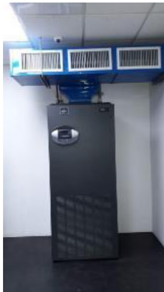
Figura 34. Aire acondicionado de precisión Challenger de 5TR
