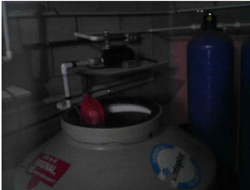
Figura 52. Depósitos y bombas para tratamiento del agua
