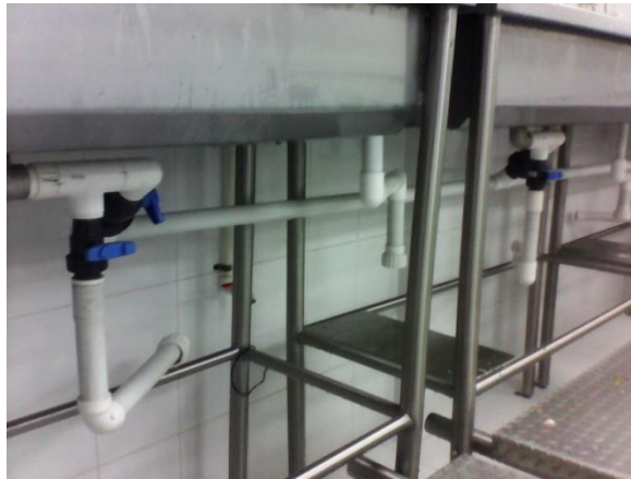
Figura 51. Sistema de tuberías para filtrado de agua
