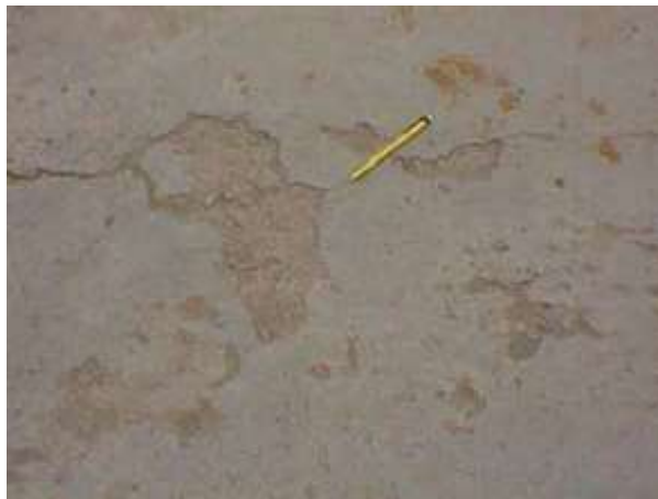
Figura 30: Descascaramiento y fisuras capilares. Jornada de actualización técnica “Diseño y Construcción de pavimentos de Hormigón” Ing. Diego H. Calo, 20 de noviembre de 2008.
