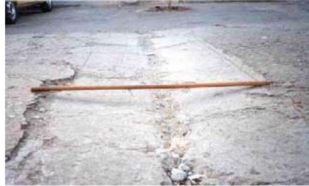
Figura 29: Hundimiento. Jornada de actualización técnica “Diseño y Construcción de pavimentos de Hormigón” Ing. Diego H. Calo, 20 de noviembre de 2008.
