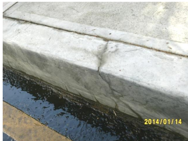
Figura 3. Grietas por dilatación
