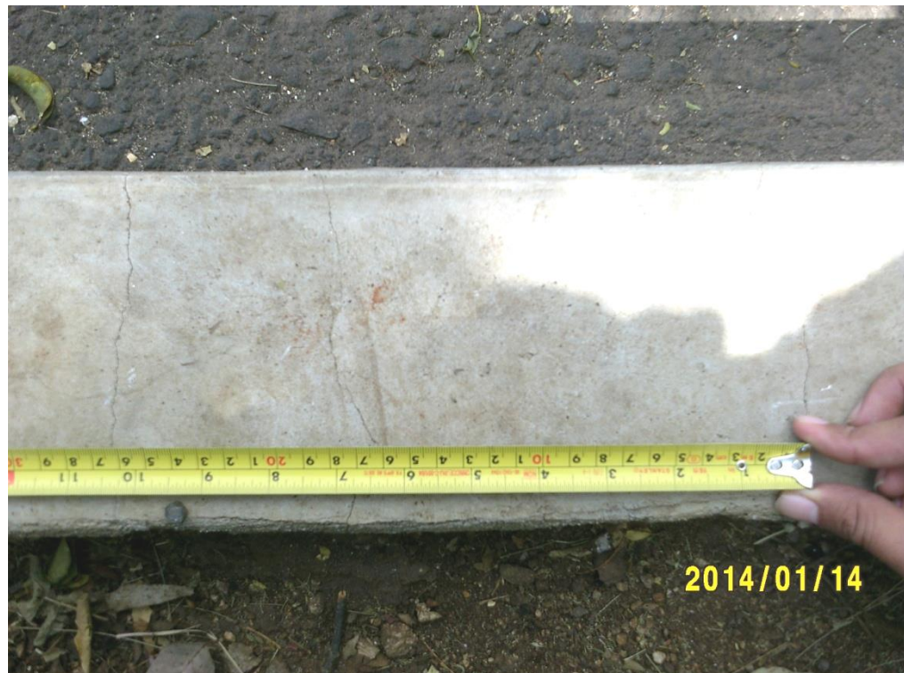
Figura 6. Separación entre grieta 2
