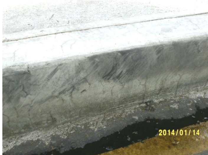
Figura 2. Grietas por contracción
