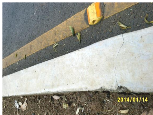
Figura 5. Separación entre grieta
