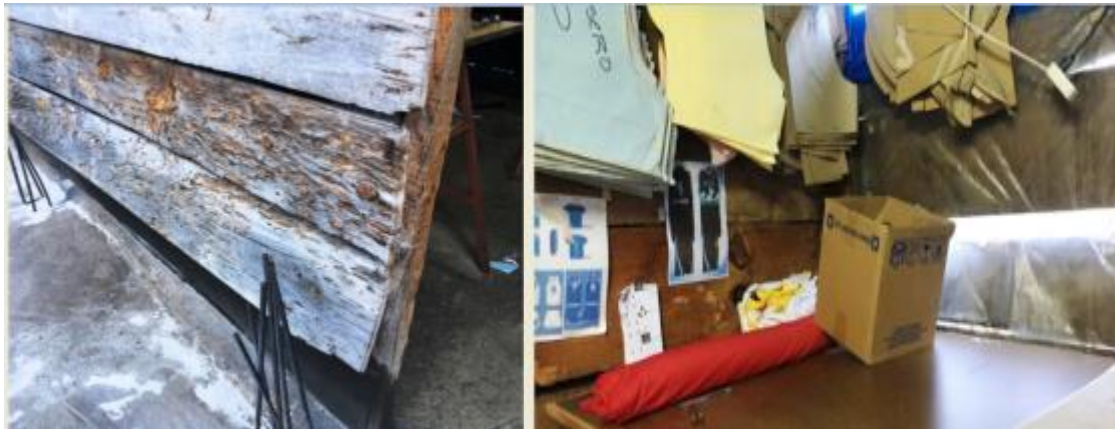
Figura 16. Estado de paredes
