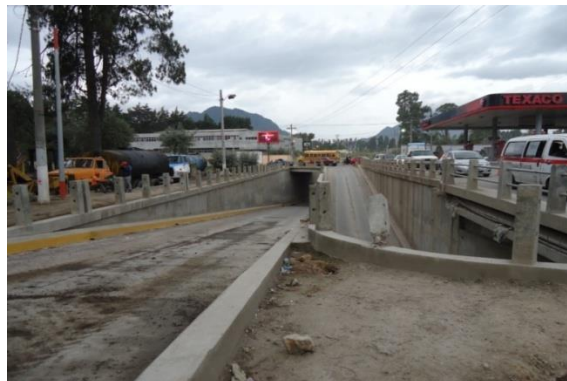
Figura 11. La falta de señalización en la entrada del puente a desnivel
