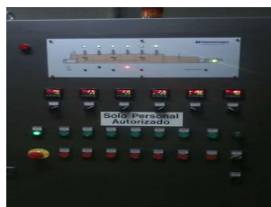
Figura 39. Panel de control de parámetros
