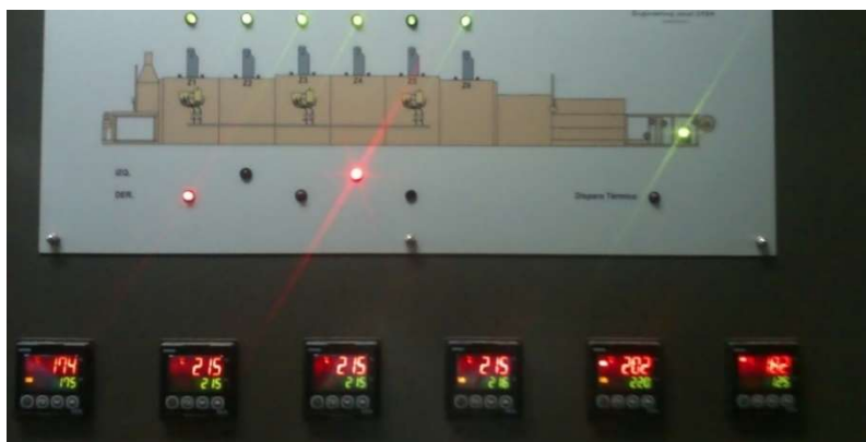
Figura 28. Panel de control de horno industrial
