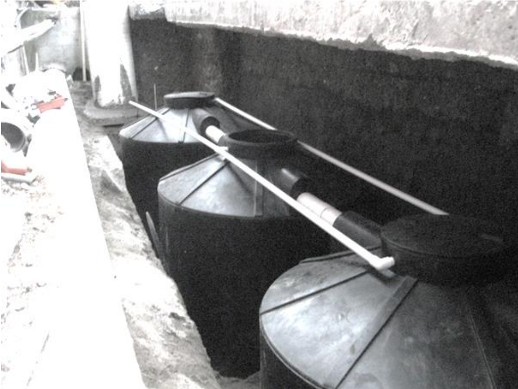
Figura 5. PTAR prefabricada (A)
