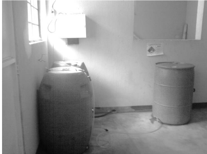
Figura 8. Caseta de cloración
