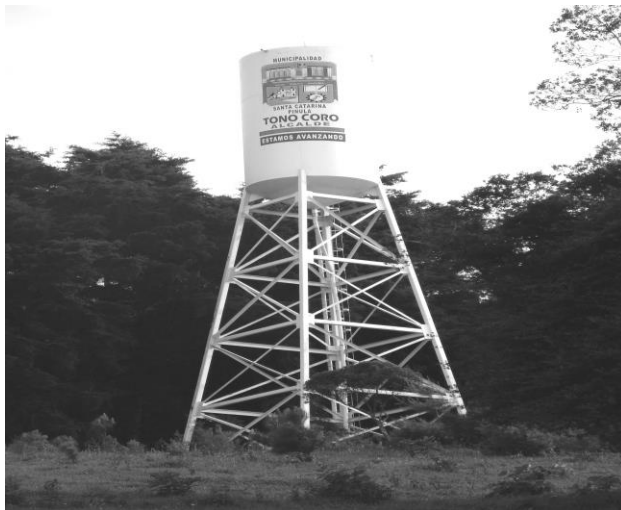
Figura 6. Tanque de almacenamiento
