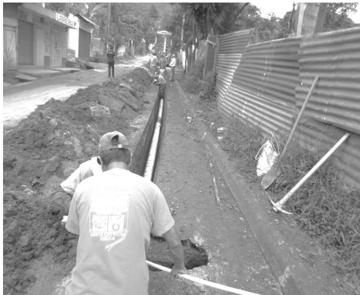
Figura 9. Línea de distribución, tubería de 4" de diámetro
