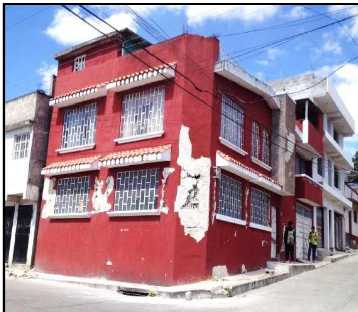
Figura 52. Configuración estructural inadecuada
