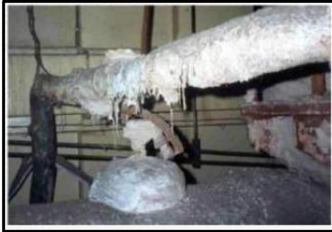
Figura 13. Tubería sin aislamiento térmico
