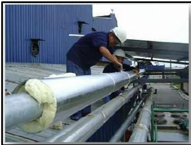
Figura 14. Tubería con aislamiento térmico
