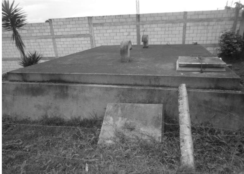
Figura 6. Tanque de almacenamiento 1
