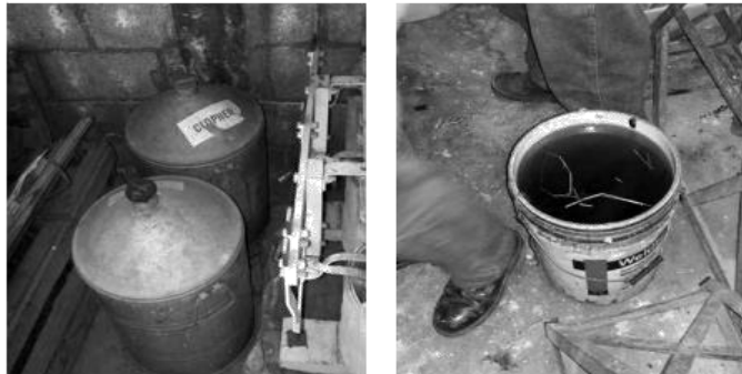
Recipientes conteniendo aceite dieléctrico contaminado con PCB.
