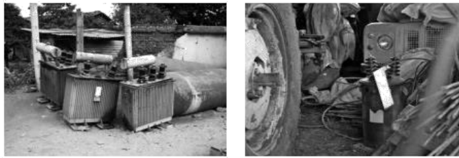
Equipos fuera de uso y almacenados en condiciones inadecuadas.
