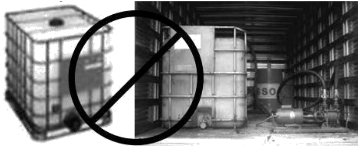
Depósitos y equipos no apropiados para el manejo de PCB.
