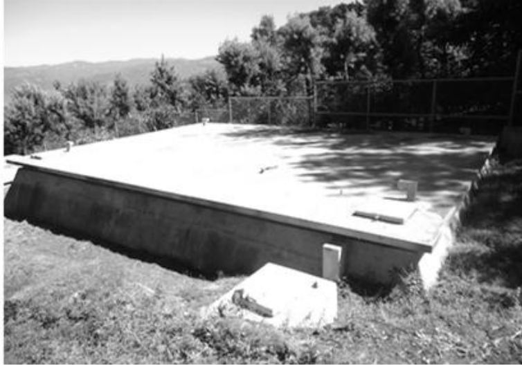
Figura 6. Tanque de almacenamiento
