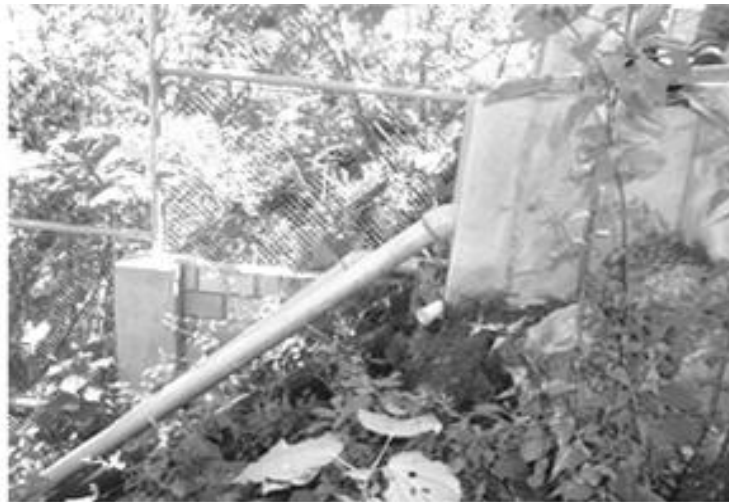
Figura 9. Línea de distribución, tubería de 4" de diámetro
