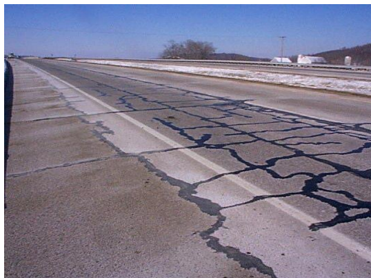
Figura 16. Grietas de bloque (resanadas)
