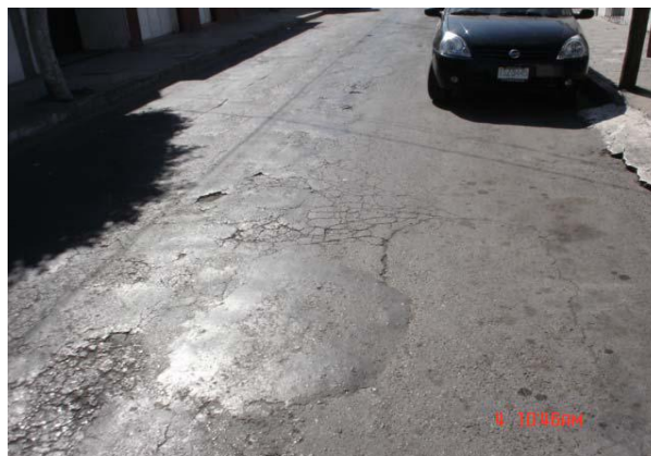
Figura 24. Afloramiento de ligante asfáltico
