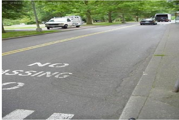
Figura 12. Fisuras en arco
