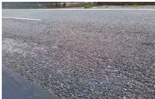
Figura 20. Pérdida de agregado
