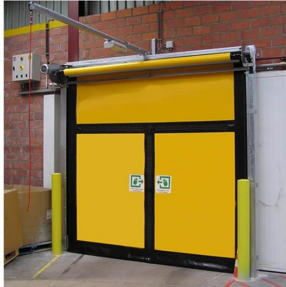
Figura 22. Salida de emergencia planta
