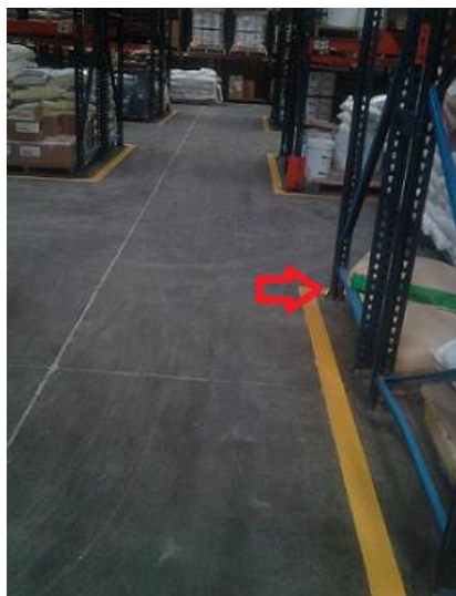
Figura 8. Carencia de elementos protectores
