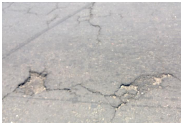
Figura 4. Bache con pérdida de base
