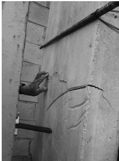
Figura 31. Principio de grieta en la parte posterior debido a la monofalla
