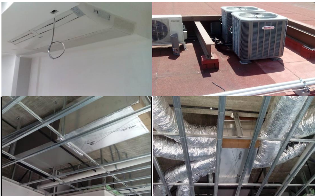
Figura 7. Instalación de aire acondicionado
