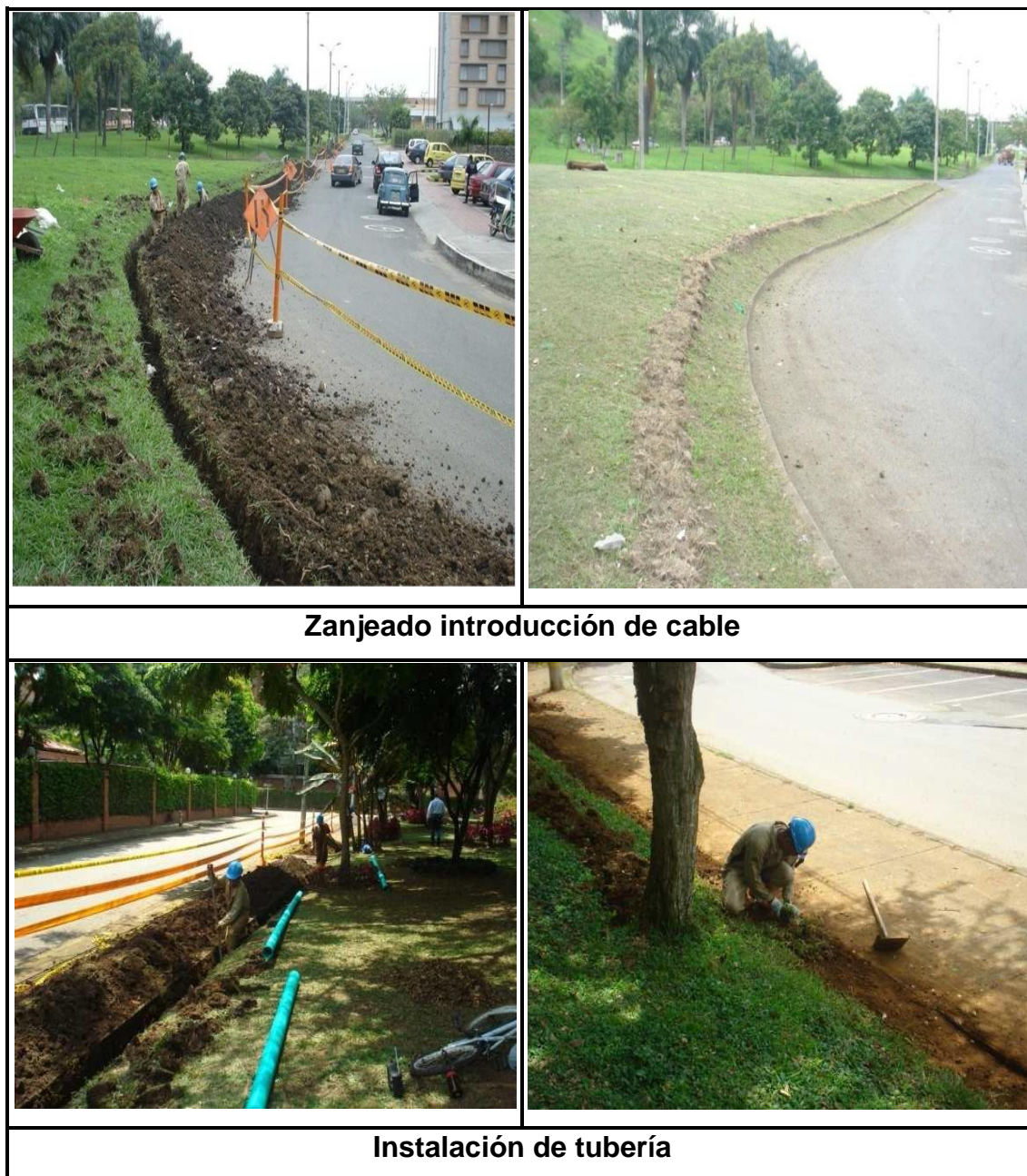
Figura 6. Proyecto infraestructura de telecomunicaciones 1
