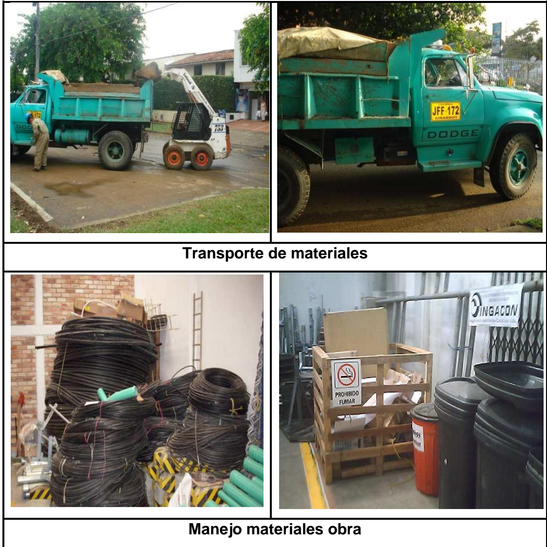
Figura 7. Proyecto infraestructura de telecomunicaciones 2
