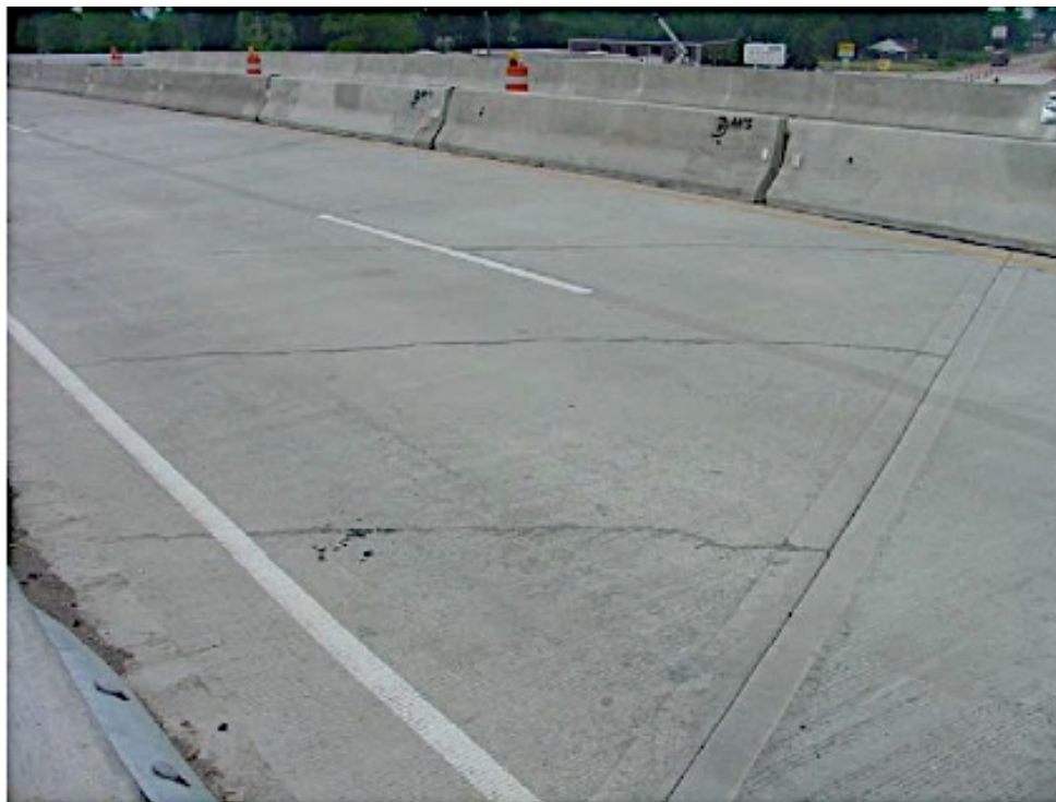
Figura 22. Esquina agrietada en losa con esviaje
