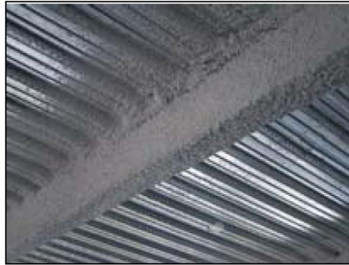
Figura 5. Viga de acero protegida con ignífugos aplicados por aspersión
