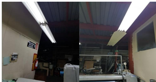
Figura 78. Luminarias de planta de Grupo Litográfico
