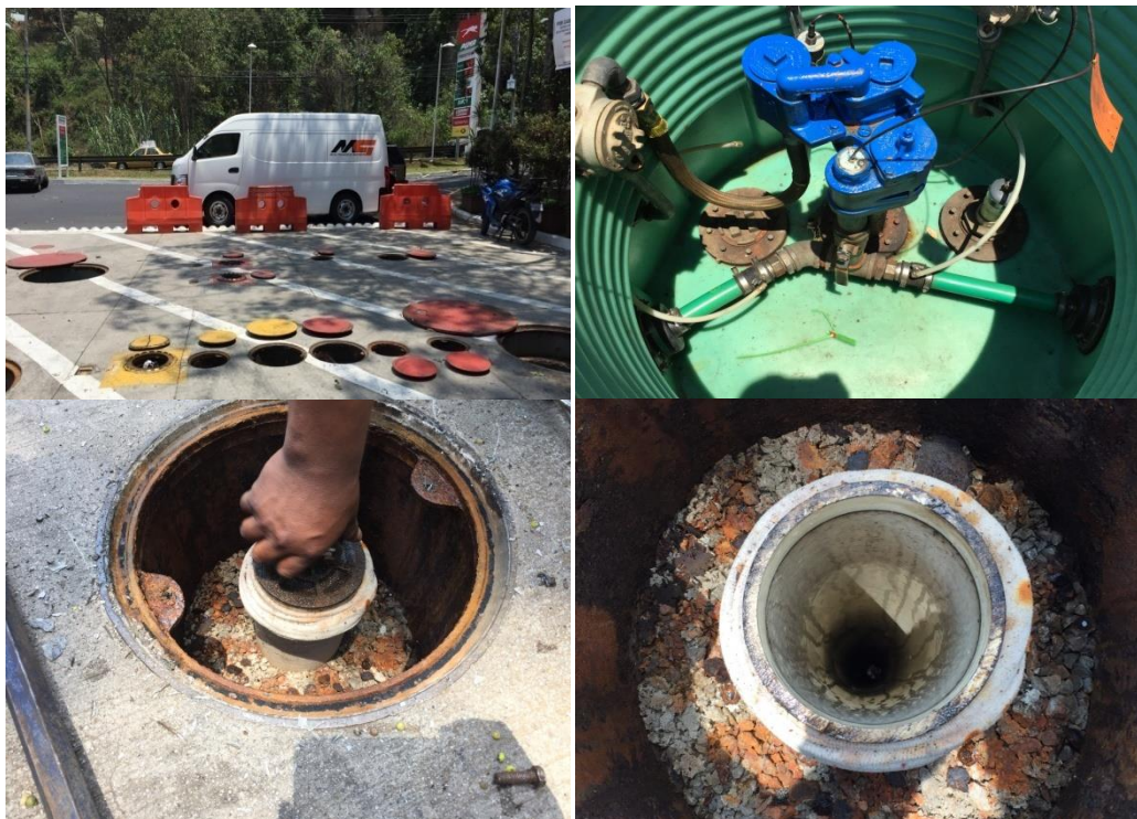
Figura 12. Tanques y tuberías gasolinera agencia
