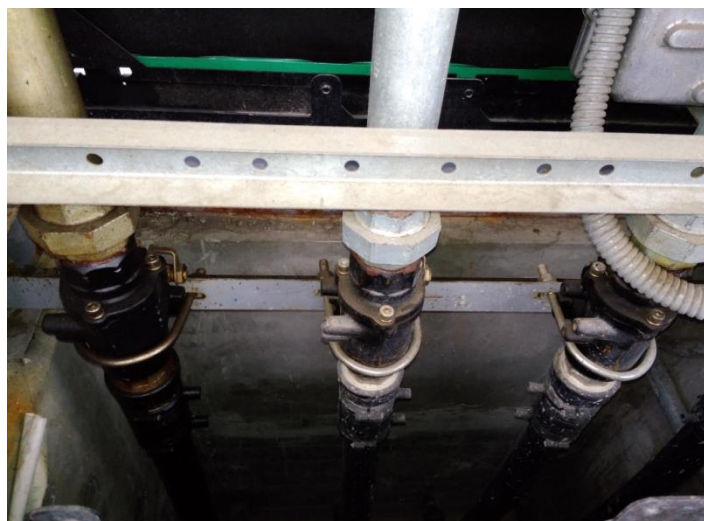
Figura 37. Tuberías del sistema
