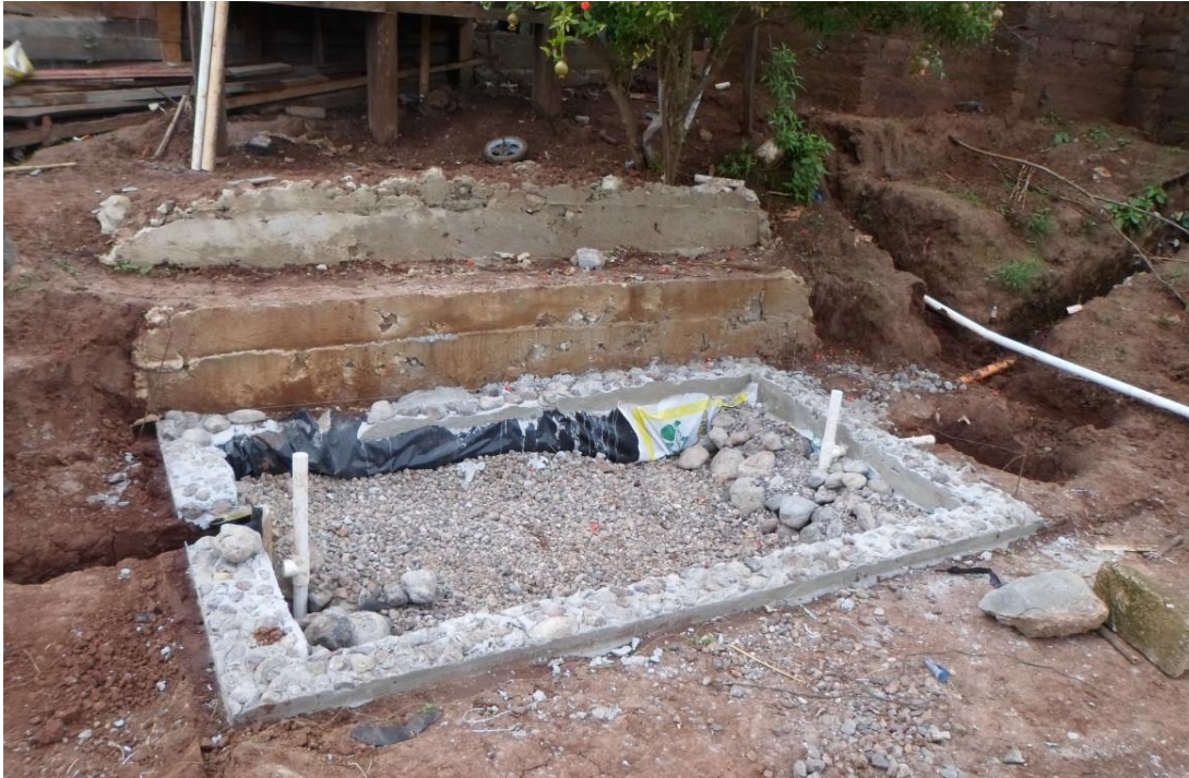
Figura 4. Lecho filtrante biojardinera
