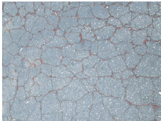
Figura 8. Fisura piel de cocodrilo
