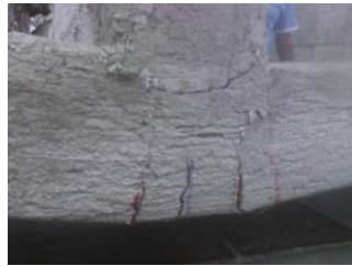
Figura 19. Grietas en zona de tensión
