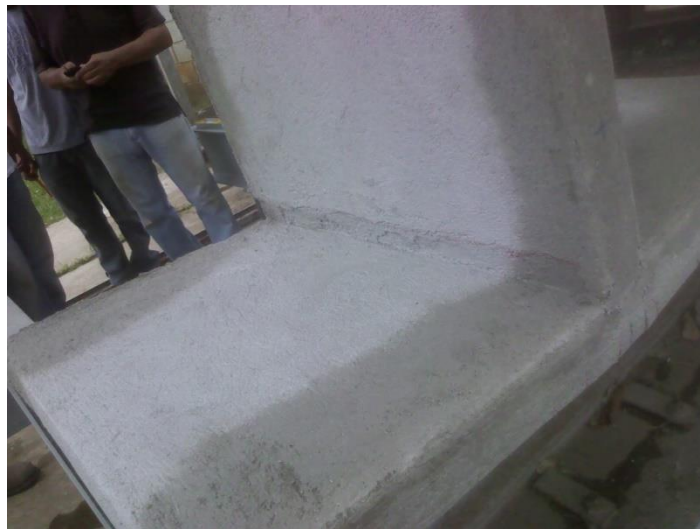
Figura 29. Humedad en los paneles
