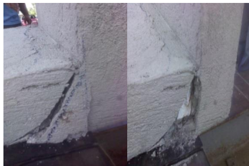
Figura 20. Desprendimiento de material por torsión
