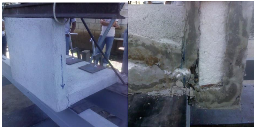
Figura 21. Fallas por deslizamiento
