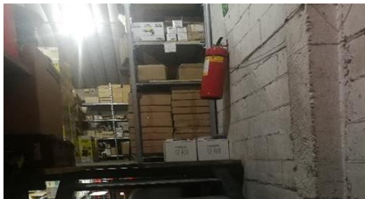
Figura 15. Extintor planta alta
