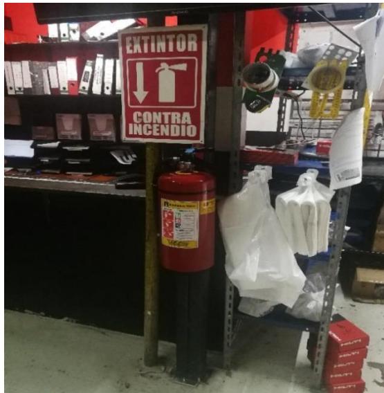
Figura 14. Extintor planta baja
