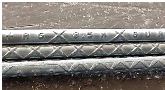
Figura 9. Identificación de barras no certificadas
