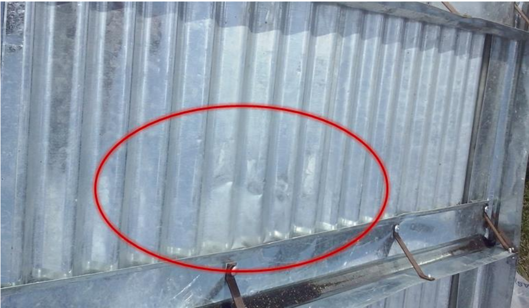
Figura 107. Daño producido por impacto sobre lámina cubierta por espesor constante de arena volcánica
