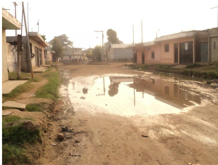
Figura 8. Falta de drenajes en calles principales
