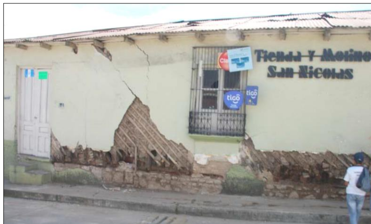
Figura 50. Área urbana de San Marcos. Falla típica en construcciones de bajareque, Guatemala, 7 de noviembre de 2012
