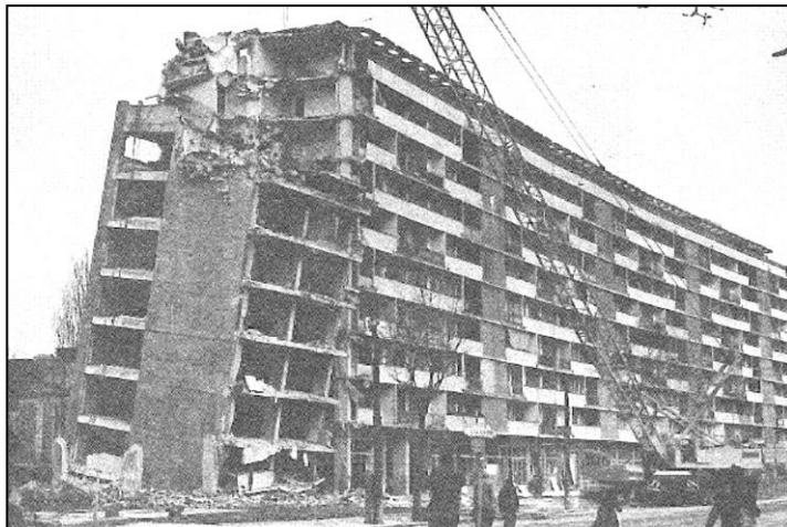
Figura 64. Piso débil, colapso parcial del edificio, Rumania, 1977
