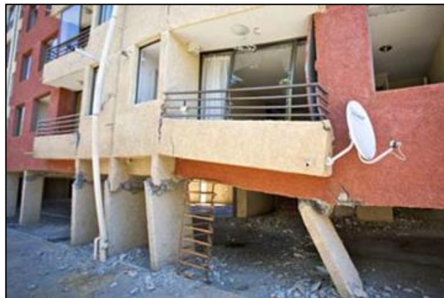
Figura 60. Edificio con piso débil, se aprecia un amplio espaciamento entre muros estructurales con irregularidades, Chile, 2010
