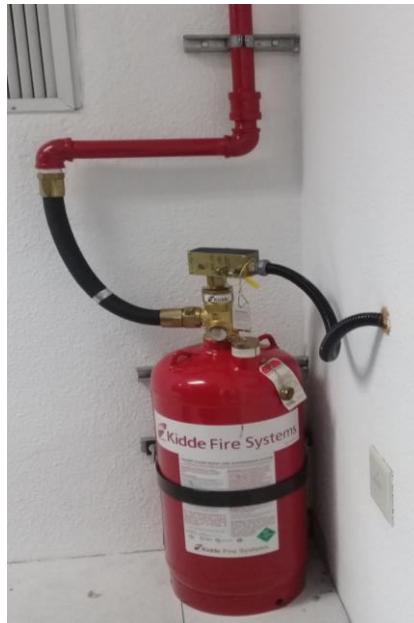
Figura 62. Extintor FM200, data center
