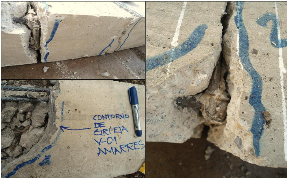
Figura 43. Fallas en estribos de vigas con amarres
