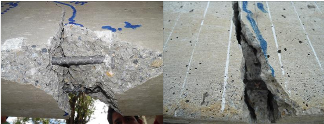
Figura 48. Fallas entre estribos de vigas sin amarres
