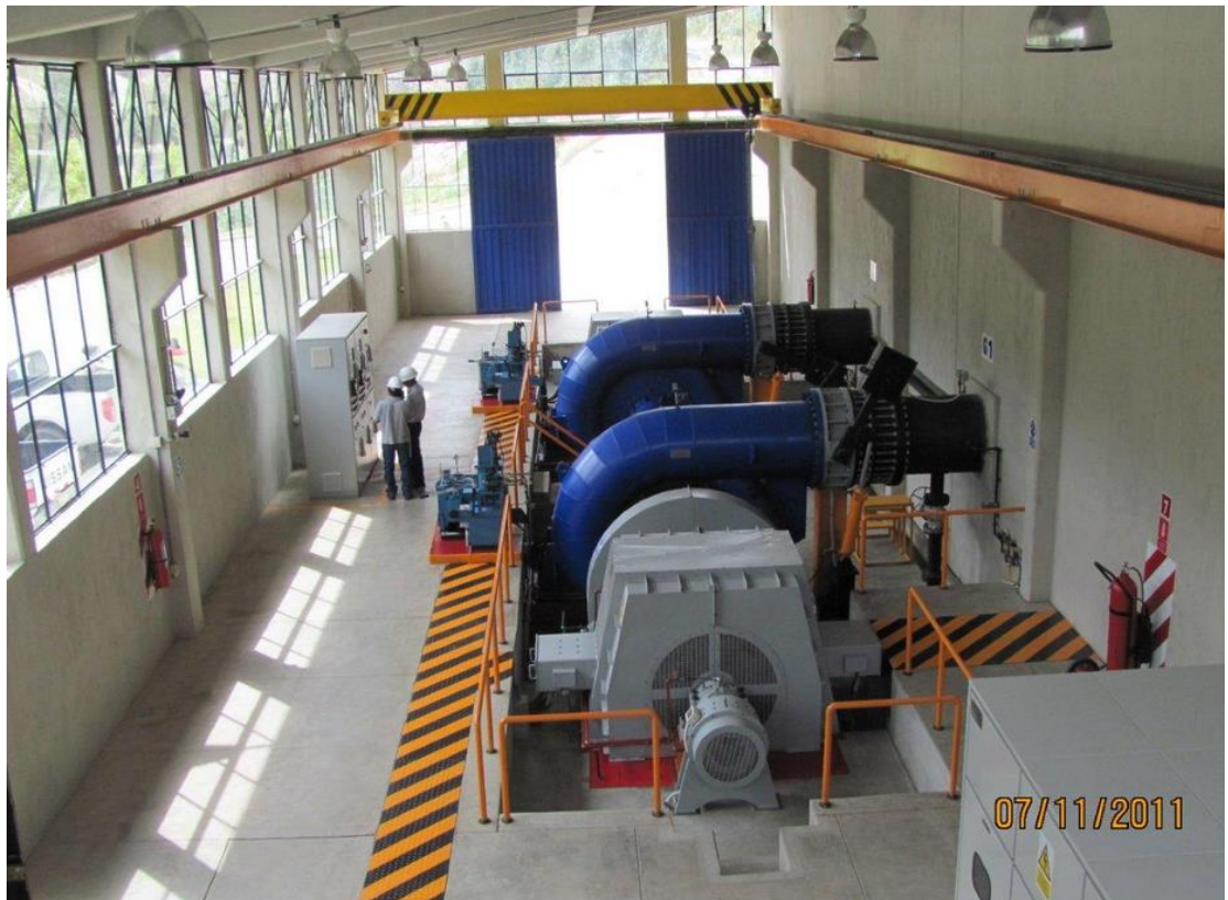
Figura 16. Casa de máquinas–turbinas hidroeléctrica Los Esclavos
