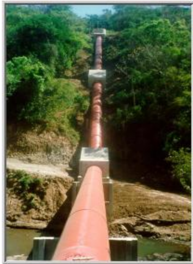
Figura 15. Tubería de presión
