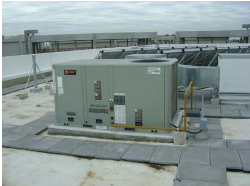
Figura 18. Equipo de aire acondicionado
