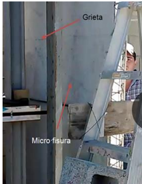
Figura 28. Grietas presentadas durante el ensayo de impacto
