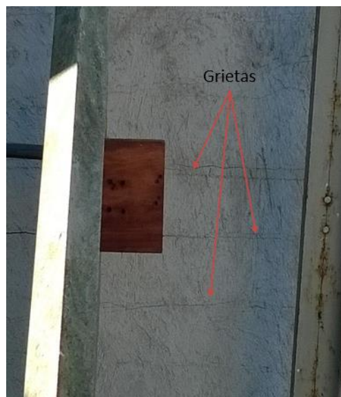
Figura 21. Agrietado del panel
